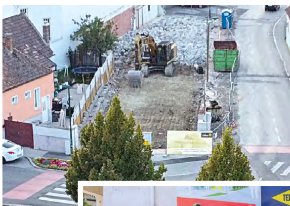
Die Abrissarbeiten sind beendet, bereits nächsten Oktober soll die neue Bankfiliale in der Schaftriebgasse eröffnen
